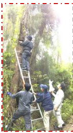
監視カメラ設置
